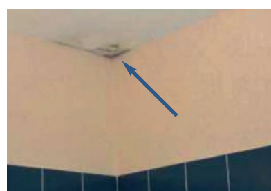
Désordre dû à la condensation. Pas de traitement du pont thermique
